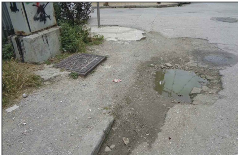
Ένα κατεστραμμένο πεζοδρόμιο που έγινε και μια μικρή λίμνη!!!
