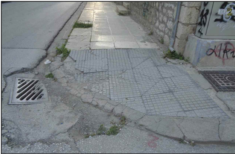
Ένα ακόμη πεζοδρόμιο που χρήζει άμεσης αποκατάστασης!!!
